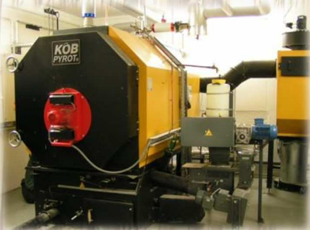
Chaudière Köb 400 kW
